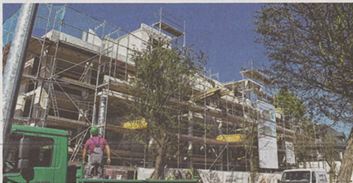
Die Bauarbeiten am „Anton-Raky-Haus“ sind in vollem Gange. Foto: Günther von Fricken
